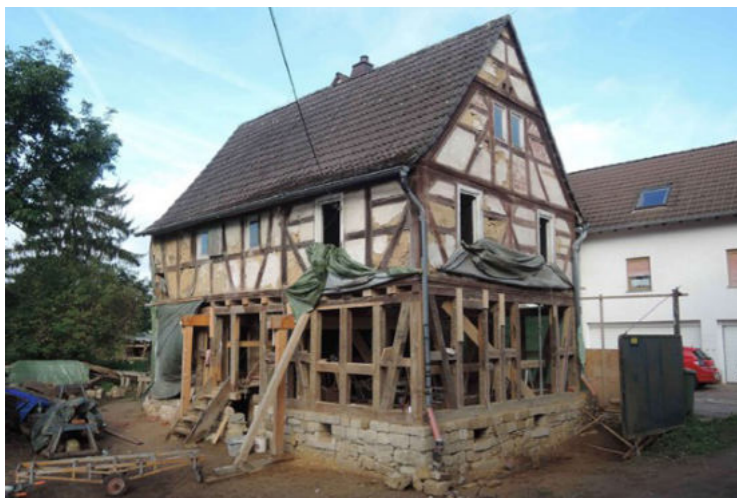
Abbildung 9: Fachwerkrekonstruktion im Erdgeschoss (Quelle: Gesine Schmidt und Klaus Heim)
